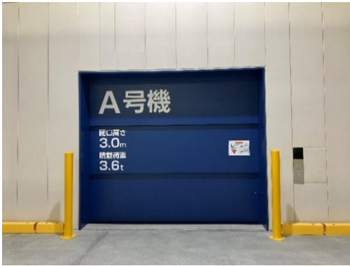
荷物用エレベーター
