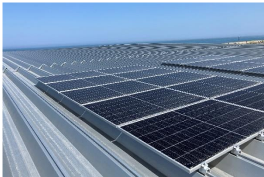
太陽光発電設備
